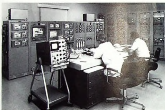
Blick in den Überwachungsraum
