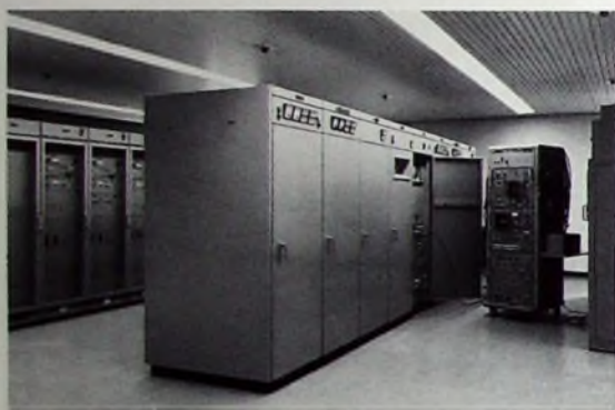
Sendersaal des Senders Hornisgrinde
