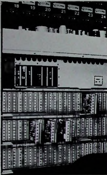
Bild 6. Bei den aufwendigen Studiomaschinen füllen die Verstärkereinschübe einen ganzen Schrank. Für den Service sind sie ohne Ausbau zugänglich
