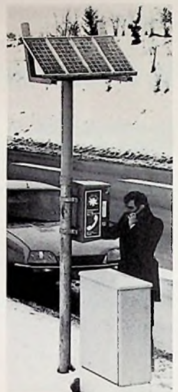
Ein beleuchtetes Notruftelefon mit einer Stromversorgung über Solargeneratoren wurde auf der Bundesstraße B14 im Schwarzwald in Betrieb genommen. Die 0,5 m 2 großen Generatoren liefern eine Leistung von maximal 40 W. (Bild: AEG-Telefunken)
