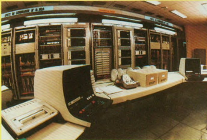
Salle de commande E12 (Photo SIC-PTT).
