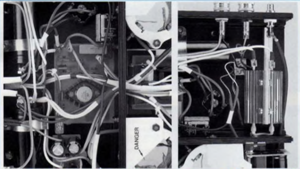
Le module de stabilisation avec à l'arrière les deux volumineux condensateurs de filtrage de 47 000 \mu F / 16 V.
