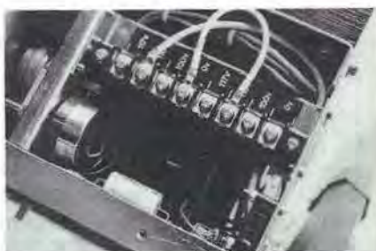
Câblage du transfo
