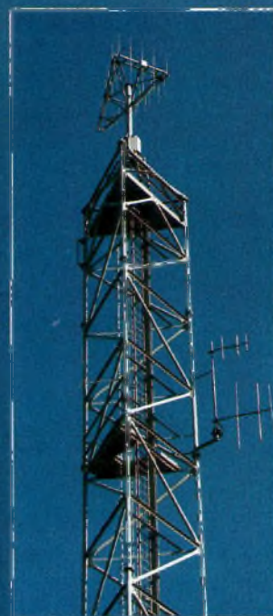
Une antenne large bande équipe le haut du pylône avec un rotor très vélocé.
