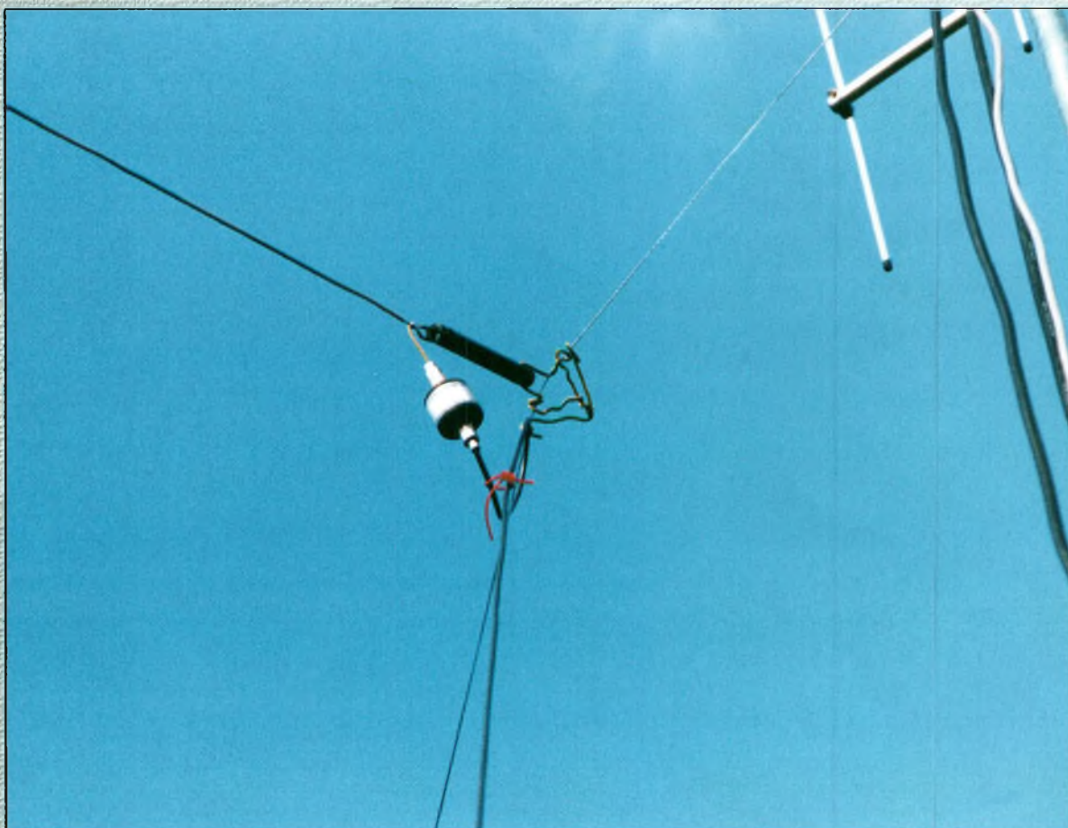
BALUN ITA MTFT en bout d'une antenne long fil.
