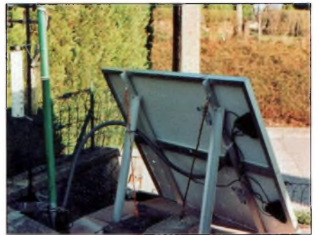
Vue de l'arrière des panneaux avec la structure en aluminium, elle est lestée par deux parpaings pleins.
