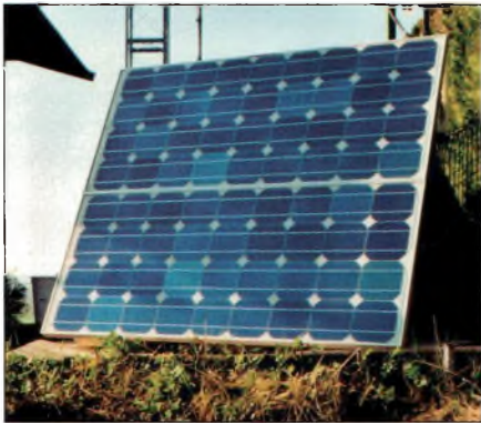
Les deux panneaux solaires orientés plein sud et inclinés à 65 degrés, fin mars 2005.
