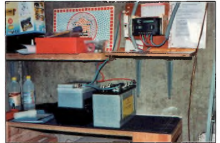
La salle des batteries
