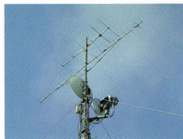
Le haut du pylône de 144 à 24 GHz.
