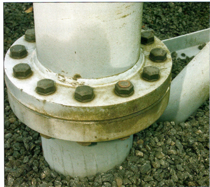
L'embase du pylône, une pièce de 1 euro est déposée sur l'un des boulons pour donner une idée des proportions.
