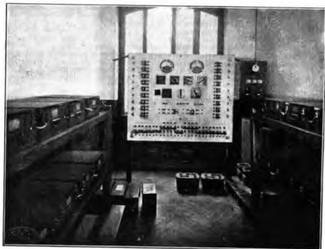
Figura 26 — Sala degli accumulatori
