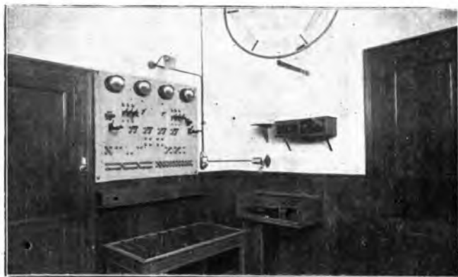
Quadro di carica e ricevitore di controllo
