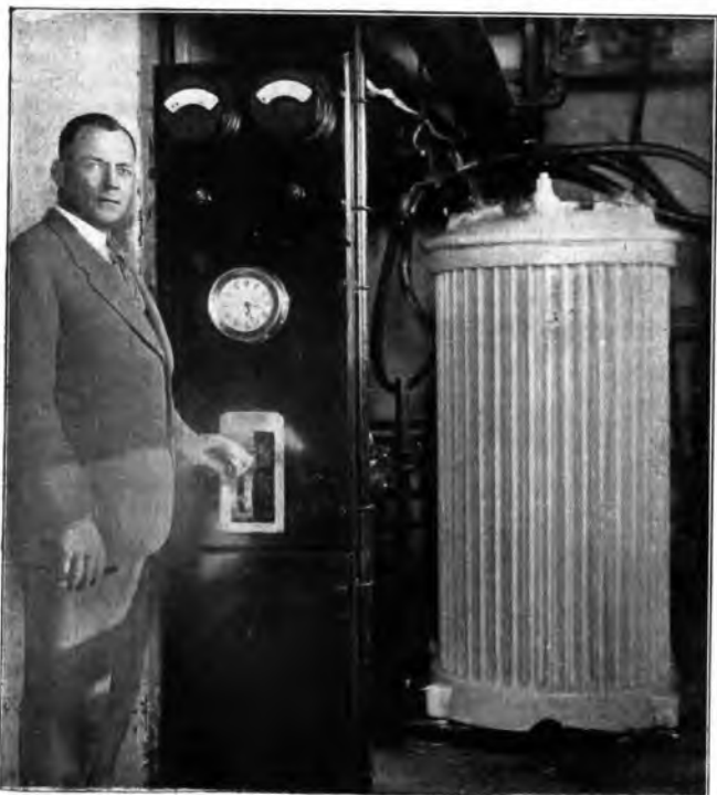
Durante i mesi invernali, si usa da talune stazioni radiofoniche, onde evitare la formazione di ghiaccio sui conduttori d'antenna, di riscaldare i conduttori stessi, facendo circolare in essi una intensa corrente a bassa tensione.
