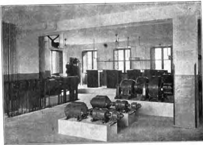
Fig. 3 — Stazione di Roma da 50 Kw. — Sala macchine
