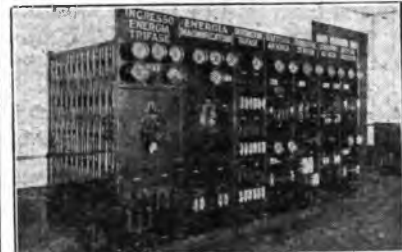
Quadro generale di comando
