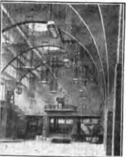
Una stufa dell'Ambasciata inglese di Washington recentemente costruita con impianti di riscaldamento invisibili disposti nell'interno dei muri.
