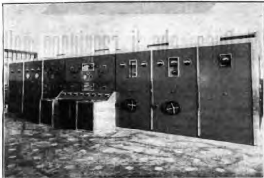
La sala pannelli della stazione di Trieste.
