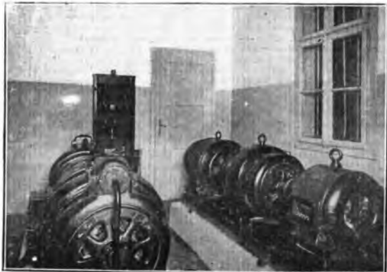
La sala delle macchine.
