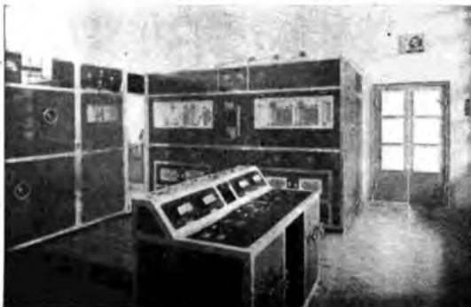
La sala pannelli a radiofrequenza: lato raddrizzatore principale.
