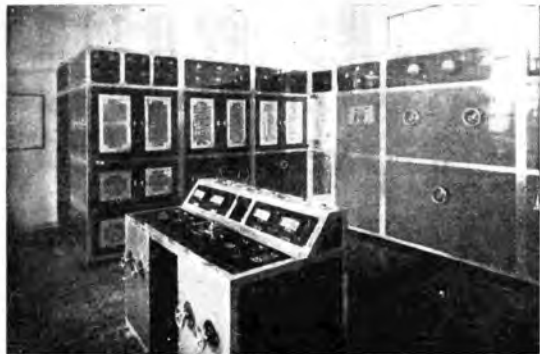
Complesso pannelli a radiofrequenza e banco centrale di comando
