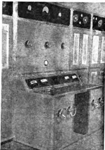
Particolare del banco di controllo del trasmettitore.
