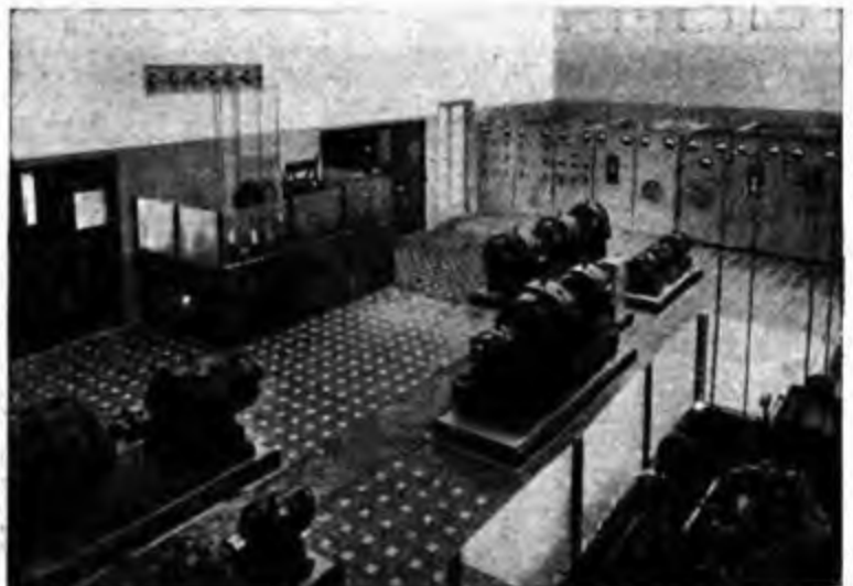
Sala macchine edificio n. 3. Trasmettitore 100 kW.
