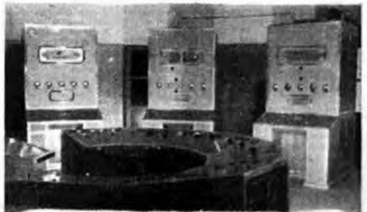
Stazione radio di Campalto (Venezia): interno del trasmettitore da 20 kW.
