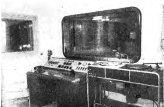
Il banco di comando del nuovo impianto
