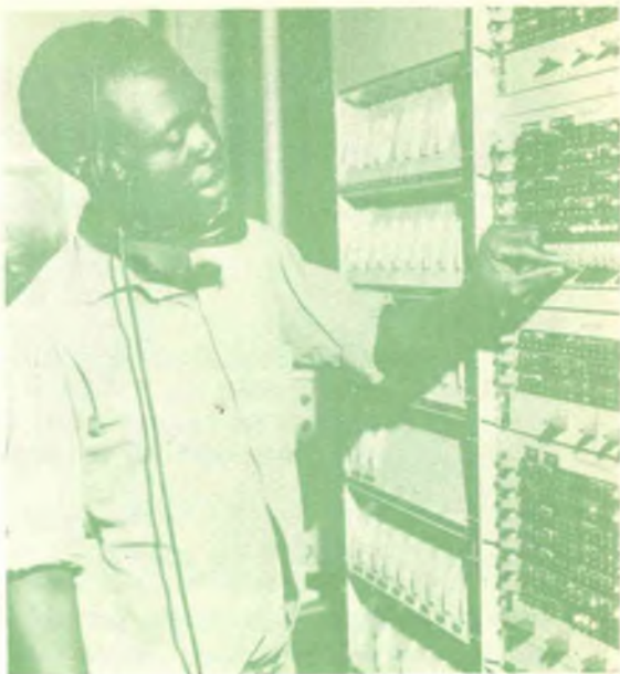
La stazione terminale di Kitwe è dotata di indicazioni di supervisione e di controlli per tutte le undici stazioni del sistema a microonde in funzione tra Lusaka e Kitwe nello stato dello Zambia.
