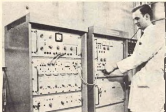
Fig. 3 - Le apparecchiature per comunicazioni costituiscono la maggiore voce fra le esportazioni di componenti elettronici della Germania Orientale. Vediamo qui un trasmettitore ad onda corta da 1 kW.
