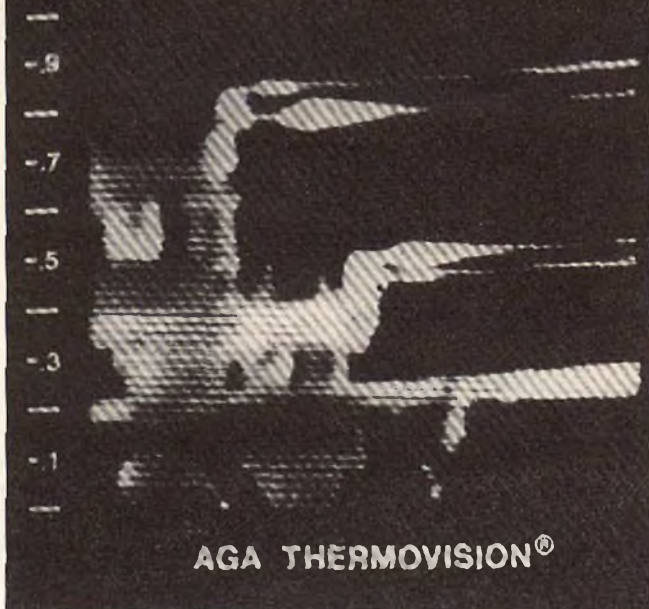
Fig. 2 - Termogramma di un sezionatore a 150 kV che mette in evidenza il riscaldamento di due fasi della linea.
