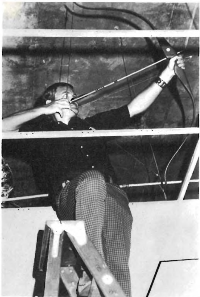
Fig. 7 - Un nuovo binomio: tiro ad arco e telecomunicazioni. Questa signora della GTE si serve dell'arco, con relativa freccia, per far sorvolare un ostacolo ad un cavo telegrafico.
