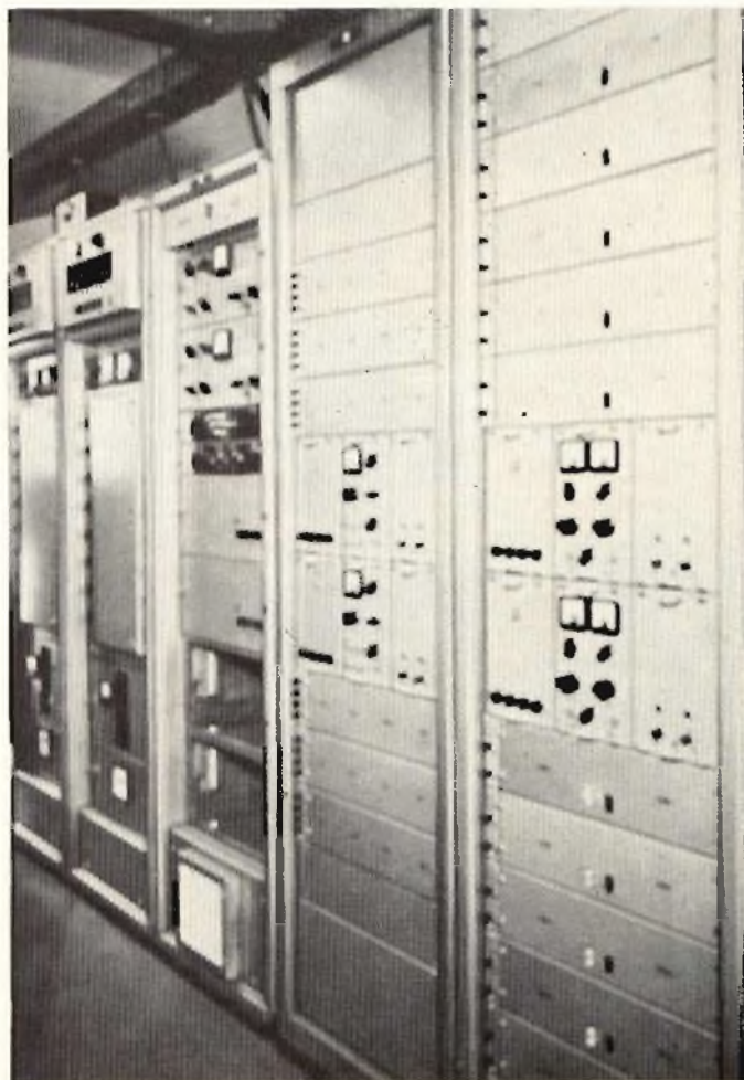
Fig. 1 - Pannelli di stazione radio.
