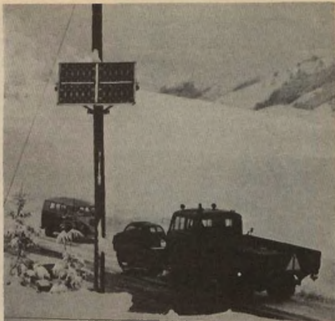
Fig. 4 - Pannelli e cellule solari utilizzati per l'alimentazione di una linea telefonica della SIP in Abruzzo (Passo Lodi).
