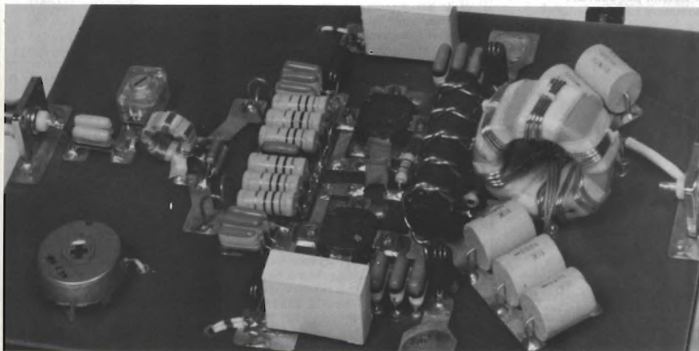
Esempio di applicazione di trasformatori r.f. realizzati mediante toroidi in ferrite e avvolgimenti in bifilare. È un amplificatore lineare a larga banda di potenza (300 W), funzionante con 2 x BLX 15 in parallelo.
