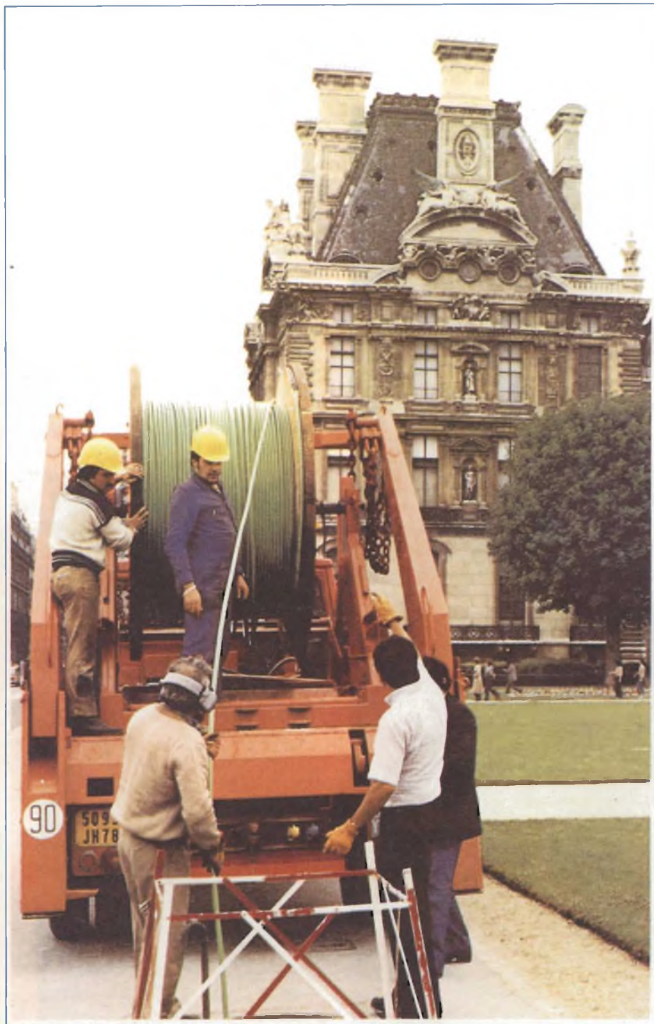
Installazione del primo cavo in fibra ottica destinato al collegamento tra le due centrali telefoniche parigine, Tuileries-Philippe-Auguste.
