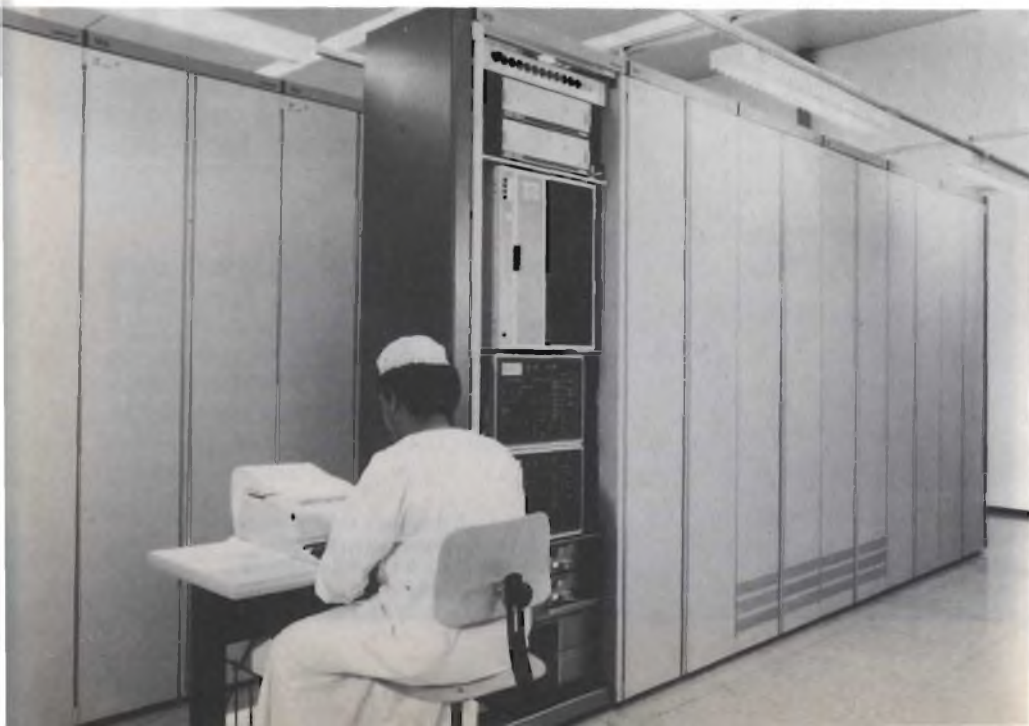
Fig. 4 - Il sultanato di Oman è uno dei 18 paesi che ha adottato il sistema digitale di commutazione telefonica EWSD della Siemens alla quale ha ordinato 5 milioni di unità di linea. La foto mostra un sistema che prevede l'allacciamento con 17.000 utenti. È entrato in servizio nel Novembre del 1984.
